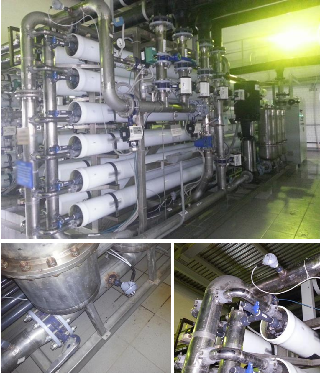
Figura 3: Panorâmica do sistema RO (em cima), Sensor ALVIM instalado antes da RO (em baixo, à esquerda), Sensor ALVIM instalado na linha do concentrado (em baixo, à direita)
