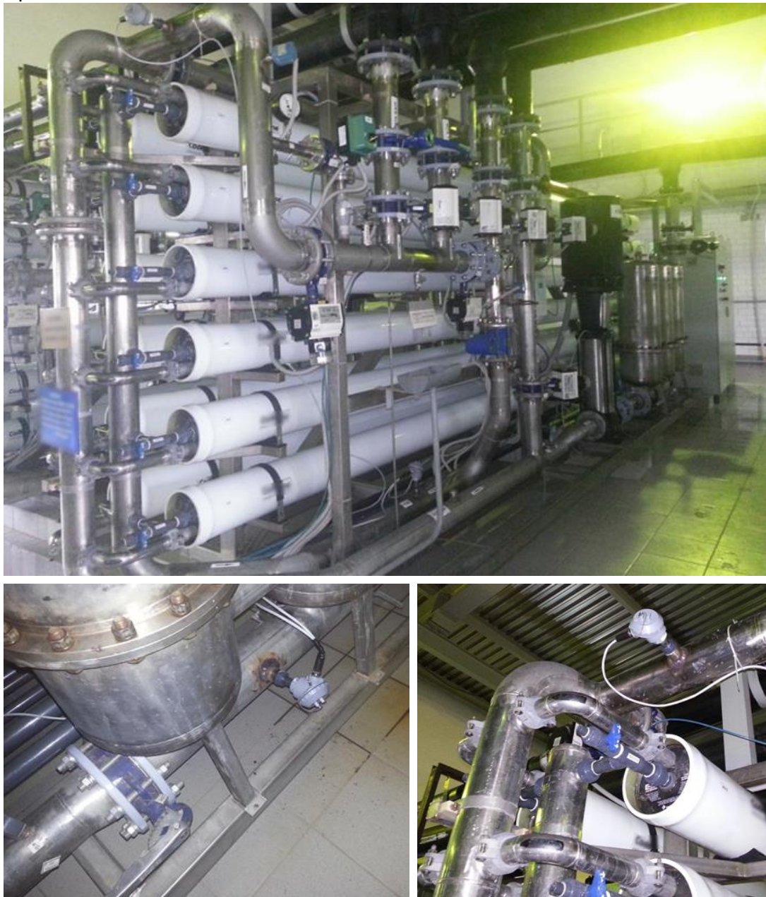
Figura 3: Panoramica del sistema RO (in alto), Sensore ALVIM installato prima della RO (in basso, a sinistra), Sensore ALVIM installato sulla linea del concentrato (in basso, a destra)
